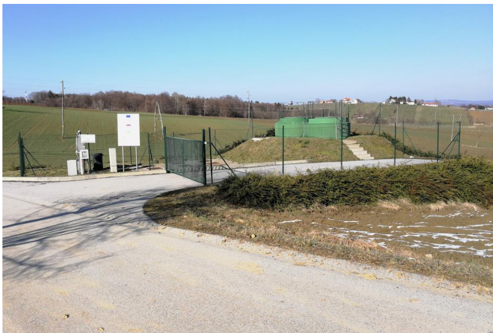
Slika 10: Čistilna naprava Lokavec
