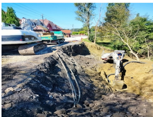
Slika 12: Sanacija plazu na javni infrastrukturi v naselju Kremberk
